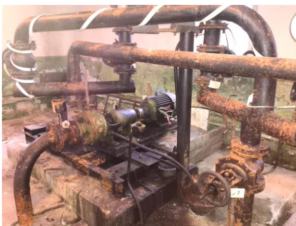
Рисунок 1.3. -Оборудование ВНС-2 на ВЗУ «Иордан»
