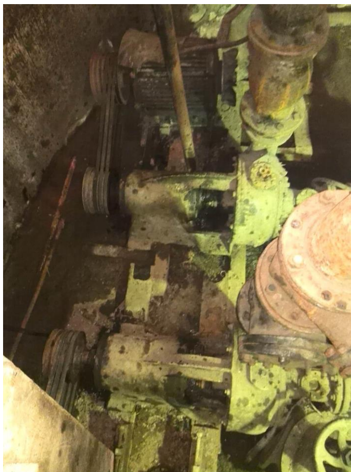
Рисунок 1.4.-Насосное оборудование КНС № 2. д.Яльгелево
